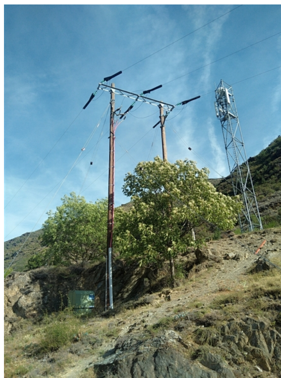
Illustration 13: Une sécurisation de la ligne électrique contre l'électrocution sur les secteurs les plus dangereux: un progrès.
